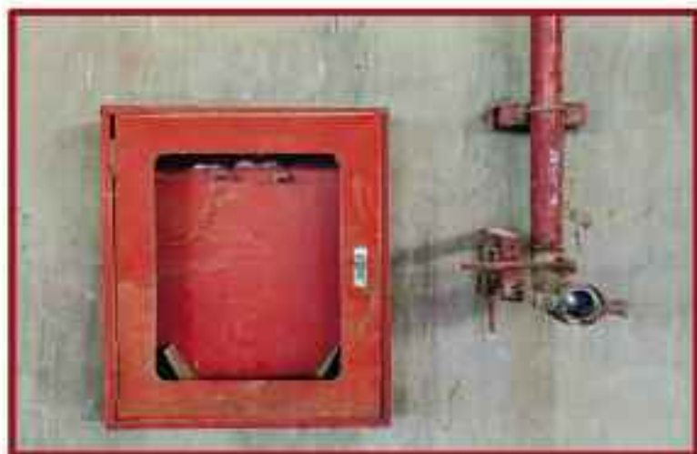
Instalación sin mantenimiento
